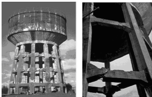
شکل ۴- تشکیل مفاصل و ترک های برشی-خمشی در زلزله سال ۱۹۶۰ شیلی [۶]
