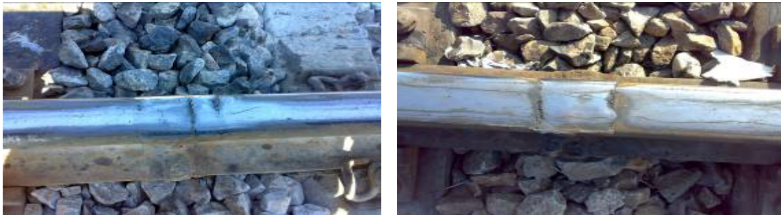
شکل ۳- نمونه هایی از ترک خوردگی و شکستگی در محل جوش درز ریل
