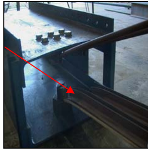
شکل شماره ۱۹: فشردگی اتصال جوشی در موضع جوش گسیخته شده
