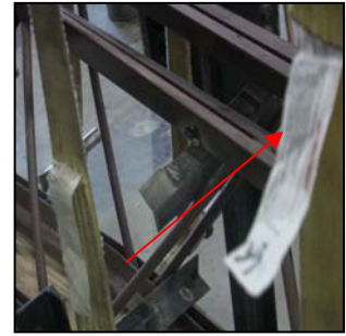
شکل شماره ۱۸: گسیخته شدن مهار افقی در اثر گسیخته شدن جوشها
