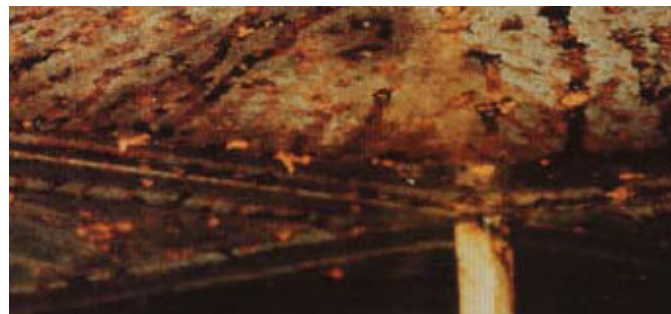
شکل ۴ تخریب موضعی بدنه داخلی در اثر خوردگی مخزن
