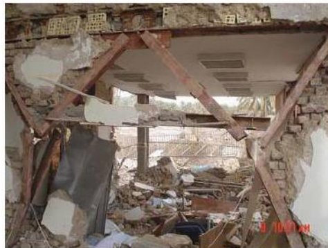
شکل ۱۰- بریدن جوش اتصال در زلزله بم
