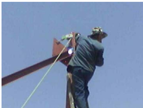
شکل ۸- استفاده از ناودانی تک و اجرای نادرست
