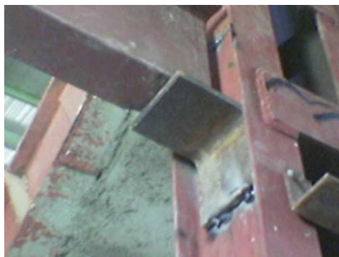
شکل ۶- عدم استفاده از سخت کننده مثلثی در نبشی نشیمن
