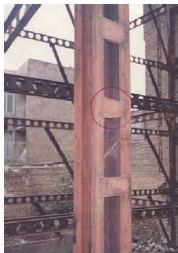
شکل ۲- اجرای نادرست ورق های بست
