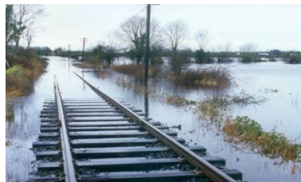
شکل (۸) - وجود آب در داخل بالاست [۸]
