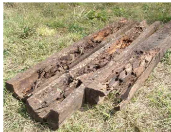
شکل (۴) - نمونه ای از خرابی ناشی از عوامل بیولوژیکی [۱]
