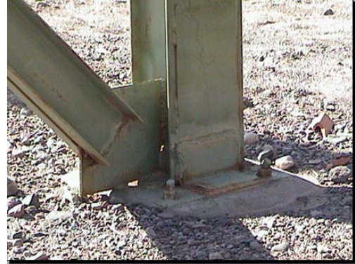
شکل ۳- کوچک بودن کف ستون.
