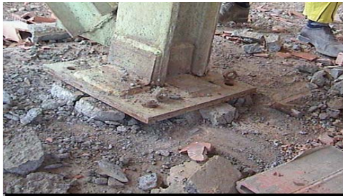
شکل ۶- کوتاه بودن طول رزوه در میله مهار و پارگی میله مهار.
