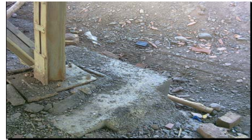
شکل ۵- کم بودن سطح مقطع میله مهارها - لقی پیچ میله مهارها - عدم یکپارچگی کف ستون ها.
