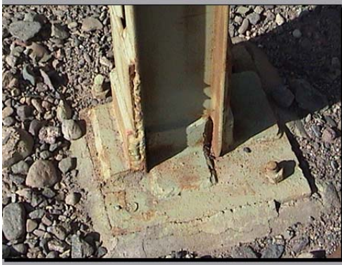
شکل ۴- استقرار نامناسب ستون بر روی کف ستون.
