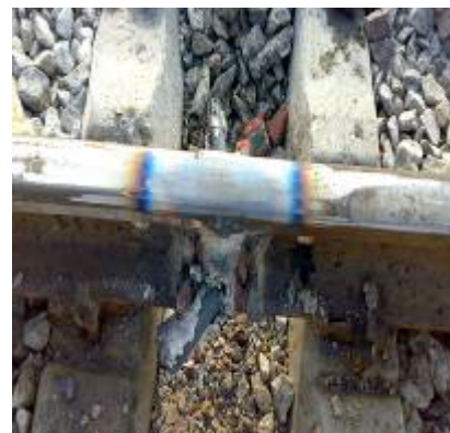
شکل (۱۲) - قسمت جوشکاری شده ریل
