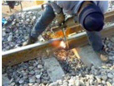
شکل (۲) - برش قسمت معیوب
